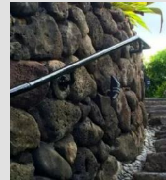
Uneven & Rough Wall Surface
